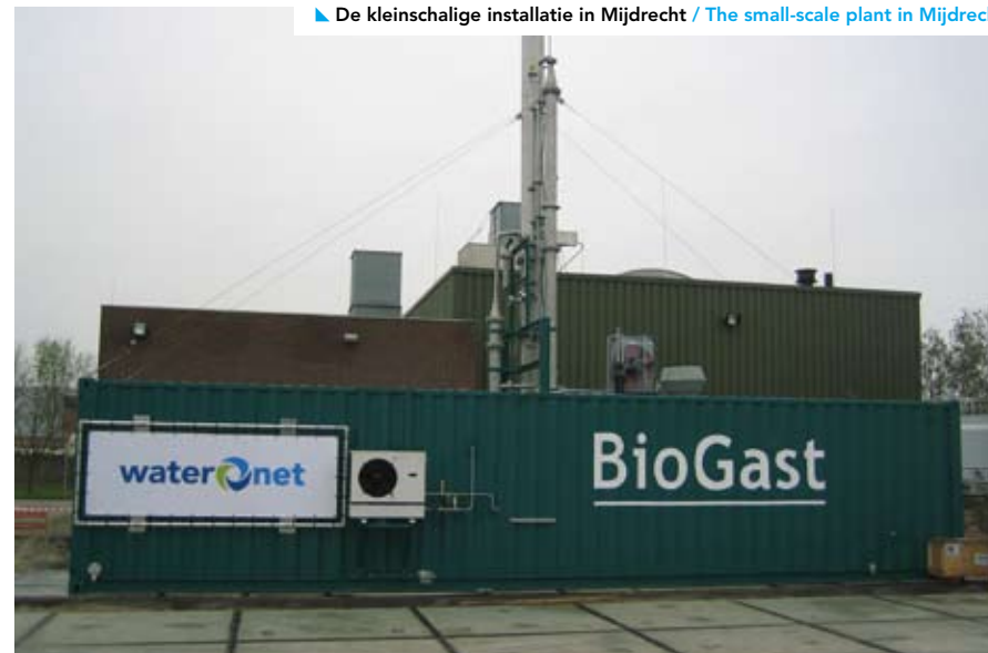
▲ De kleinschalige installatie in Mijdrecht / The small-scale plant in Mijdrecht
